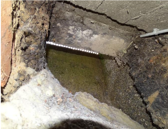
Abb. 7: Belüftungsschacht in kleinem Geräteraum
