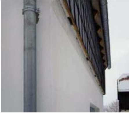
Abb. 20: Spaltenquartiere hinter Schieferverkleidung 3
